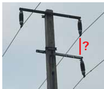
4. kép: Függő szigetelővel szerelt oszlopfej a Környe-Szár vezetékszakaszon.
